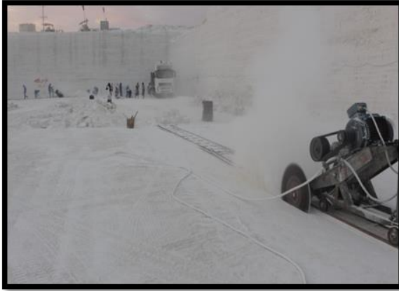
شكل (1) توضح تكديسات بودرة الحجر الجيري وتطايرها اثناء التقطيع من أحد المحاجر بمنطقة الدراسة
